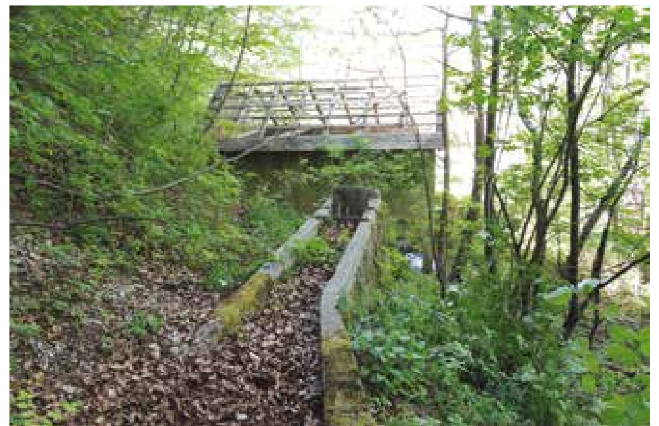
Jaz kojim je tutnjao brzak Japre odavno ispunjava truli šušanje, a u pozadini u nebo se bolno usijeca kostur negdašnjeg krova. Jaz je kanal od brane do vodenice kojim voda dotiče do badnja napravljenog od šuplje bukve ili od metala.
